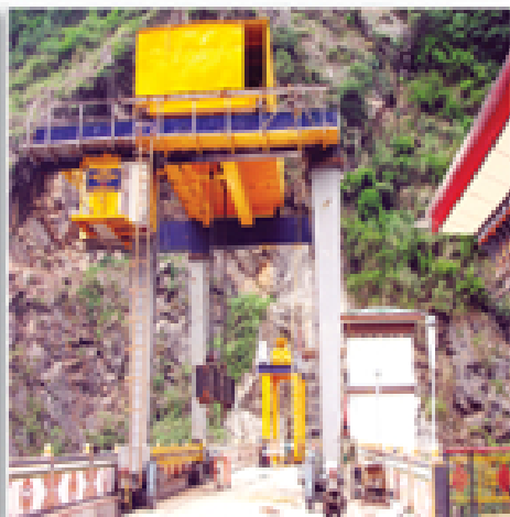
▲ 55 t. Gantry Crane-Tala, Bhutan
